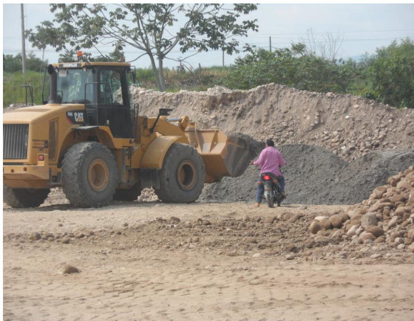
Foto 4: Riesgos identificados en instalaciones de Genesis S.A.C
