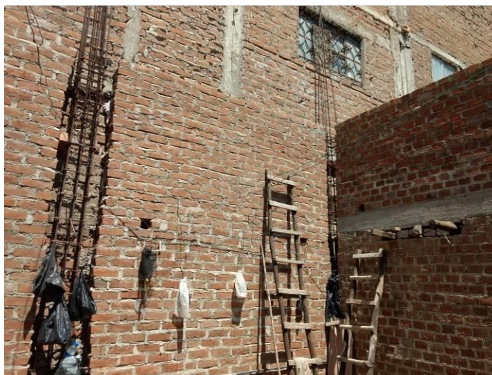
FIGURA N° 23. REFUERZO DE ACERO EXPUESTO A LA INTEMPERIE
