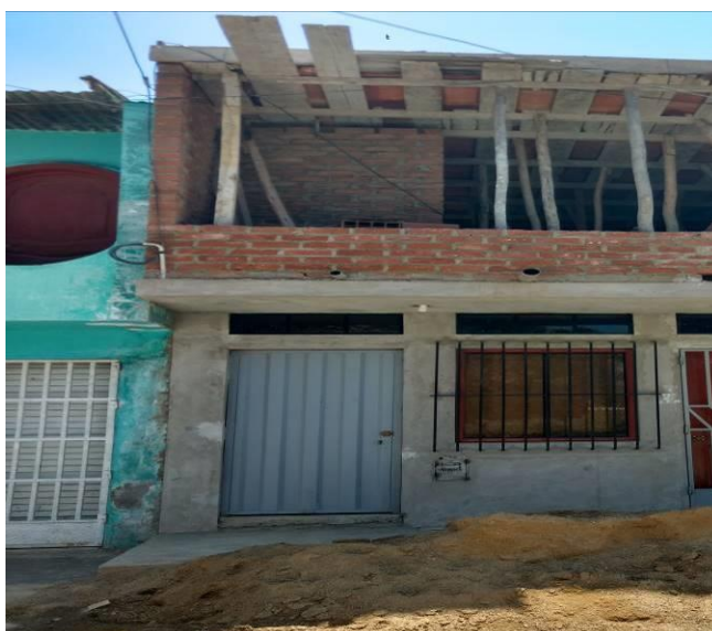
FIGURA N° 20. VIVIENDA SIN JUNTA SÍSMICA
