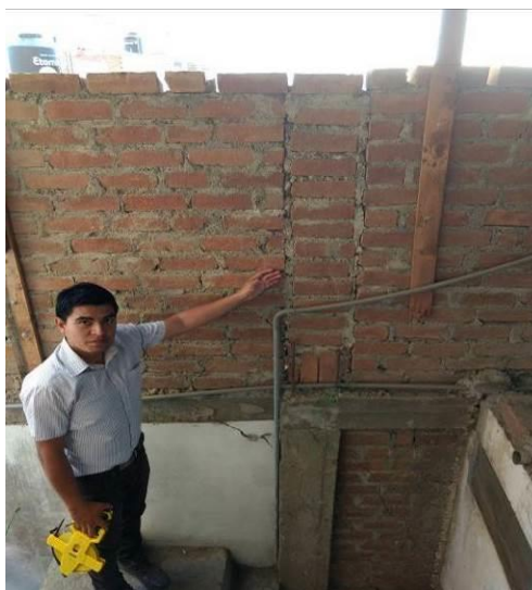
FIGURA N° 21. MUROS SIN ARRIOSTRAMIENTO
