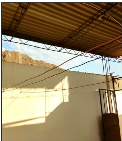
FOTO 2 : MUROS SIN ARRIOSTRAMIENTO
