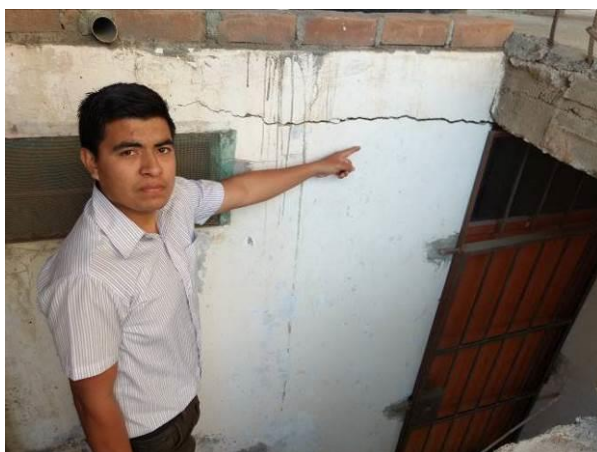
FIGURA N° 19. FISURA POR ASENTAMIENTO EN LA VIVIENDA.
