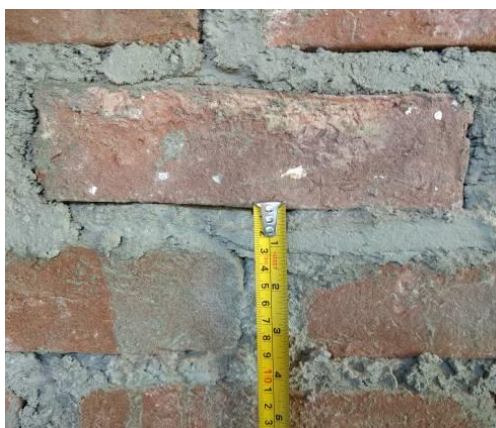
FIGURA N° 24. JUNTA ENTRE LADRILLOS MAYOR A 1.5 cm.
