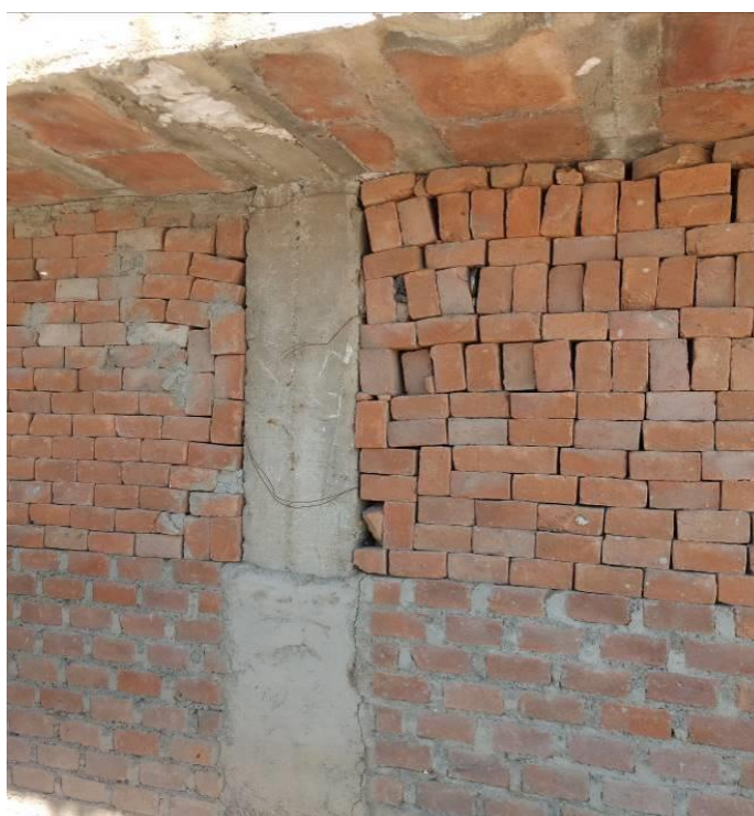
FIGURA N° 26. MALA CALIDAD DE MANO DE OBRA
