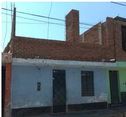
FIGURA N° 22. PARAPETOS SIN ARRIOSTRAMIENTO
