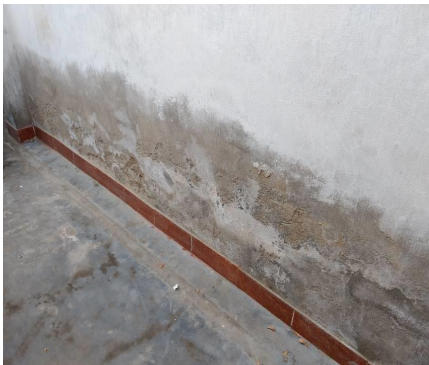
FIGURA N° 27. EFLORESCENCIA EN LOS MUROS
