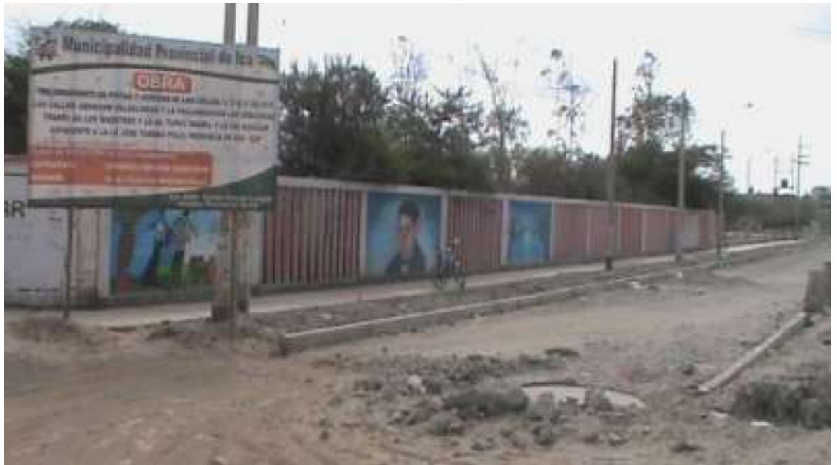
Estado de pavimento a causa de mantenimiento de redes de agua y desagüe
