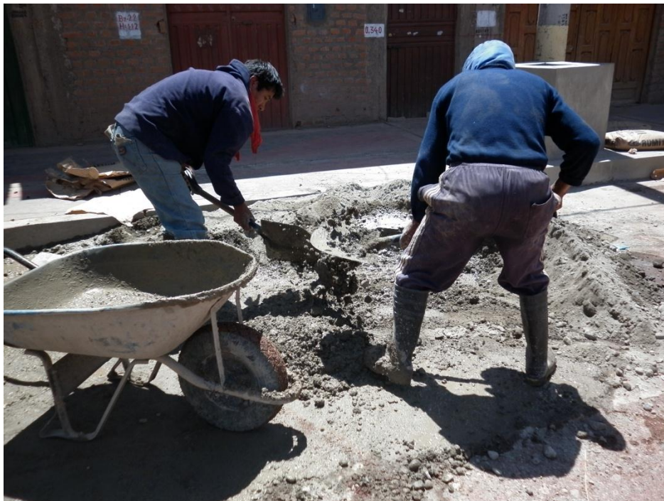
MEZCLADO DEL CONCRETO CON EXESO DE AGUA
