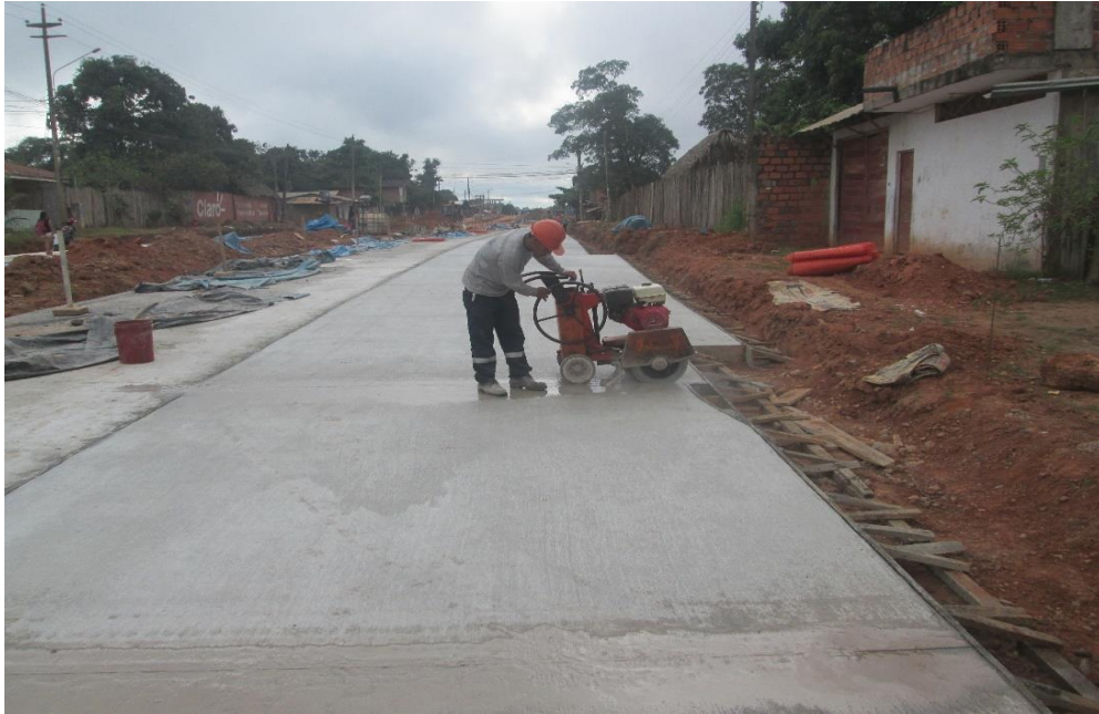
Figura N° 39: Corte con maquinaria en las juntas de contracción de las losas cortas de los pavimentos rígidos.
