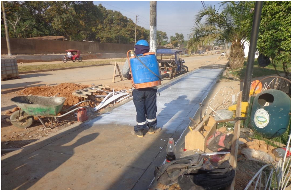
Figura N° 38: Curado del concreto con aditivo plastificante para evitar la evaporación del contenido de humedad del concreto.
