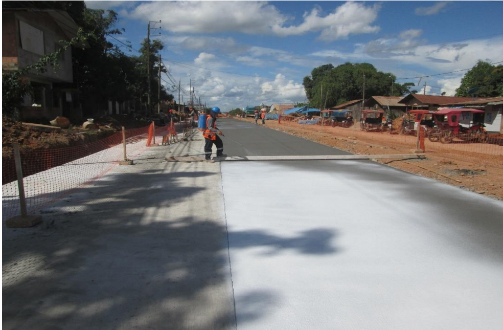
Figura N° 37: Curado del concreto con aditivo plastificante para evitar la evaporación del contenido de humedad del concreto.
