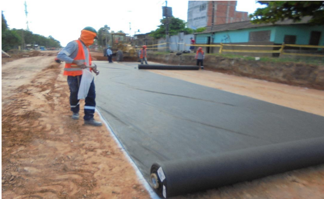
Figura N° 28: Tendido del geotextil para evitar contaminación de los materiales finos con la base granular.
