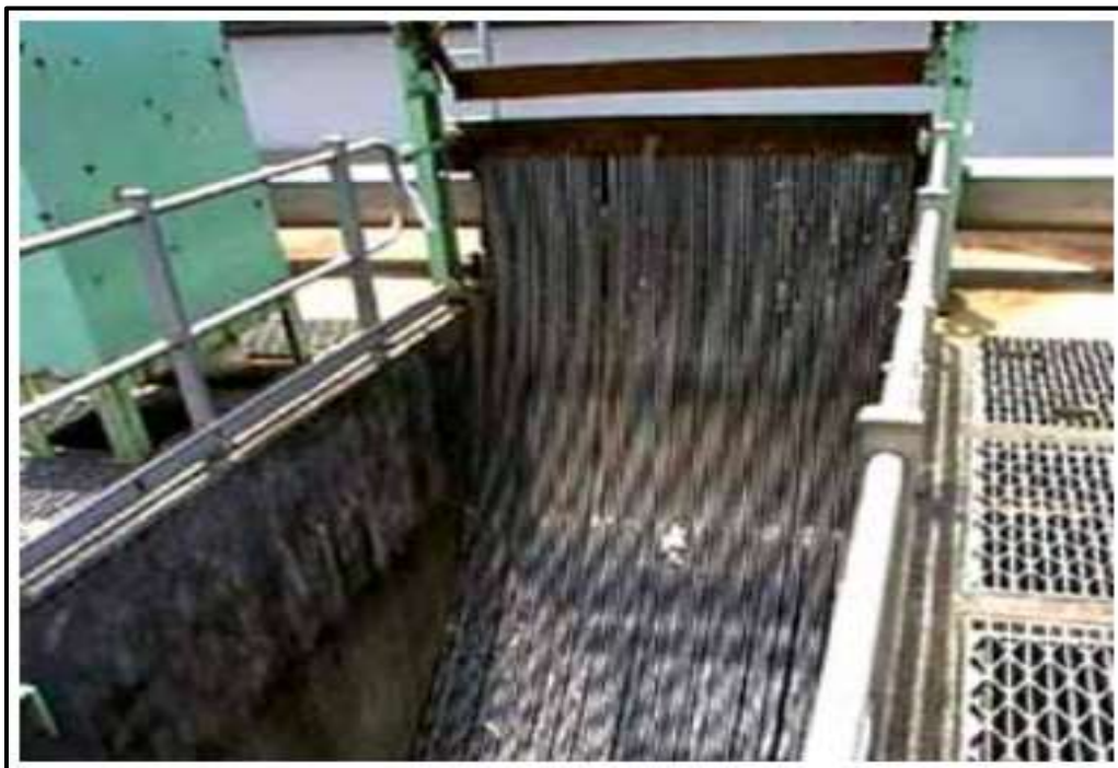
FIGURA N° 03: CÁMARAS DE REJAS (PERMITEN LA RETENCIÓN DE RESIDUOS SÓLIDOS Y MATERIAL GRUESO PREVIO AL INGRESO A LAS UNIDADES DE TRATAMIENTO PRIMARIO) 4
