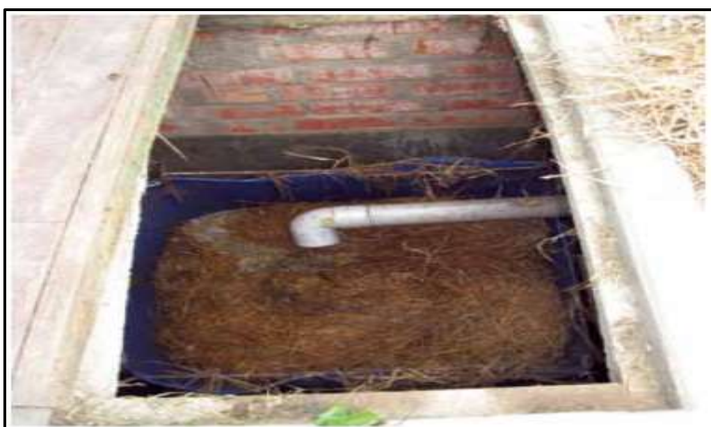
FIGURA N° 14: CÁMARAS DE TRATAMIENTO PRELIMINAR DEL HUMEDAL ARTIFICIAL VERTICAL, DONDE UNA DE LAS CÁMARAS DE REPOSO ESTÁ SIENDO APROVECHADA PARA HACER COMPOST CON LA MATERIA ORGÁNICA.
