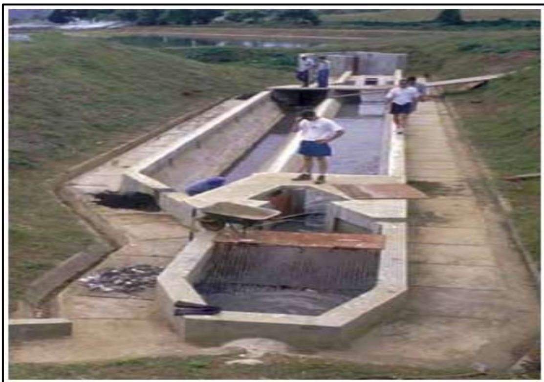
FIGURA N° 17: INFRAESTRUCTURA DE UN SISTEMA DE PRETRATAMIENTO DE AGUAS RESIDUALES, DONDE SE OBSERVA UNA REJILLA Y UN DESARENADOR, DISEÑADOS PARA UNA LAGUNA FACULTATIVA. 12
