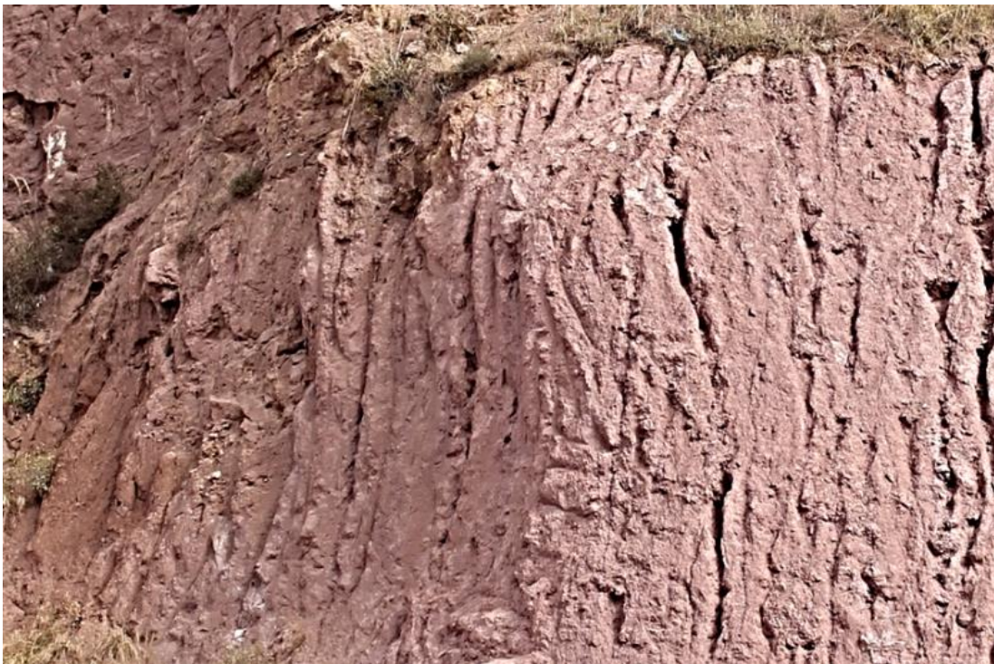
Figura 23: Se observa el trabajo realizado por las uñas de la retroexcavadora en material arcillo gravoso.
