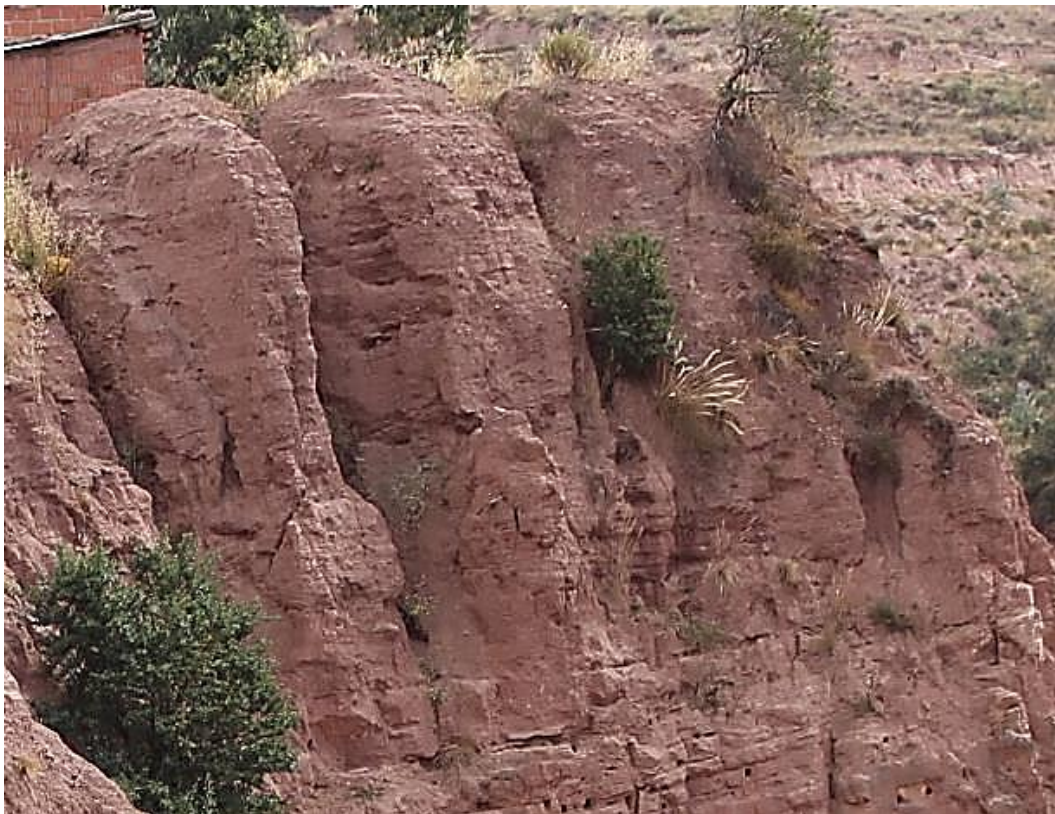
Figura 22: Gravas de matriz areno arcillosa que se presentan en la cabecera del talud.
