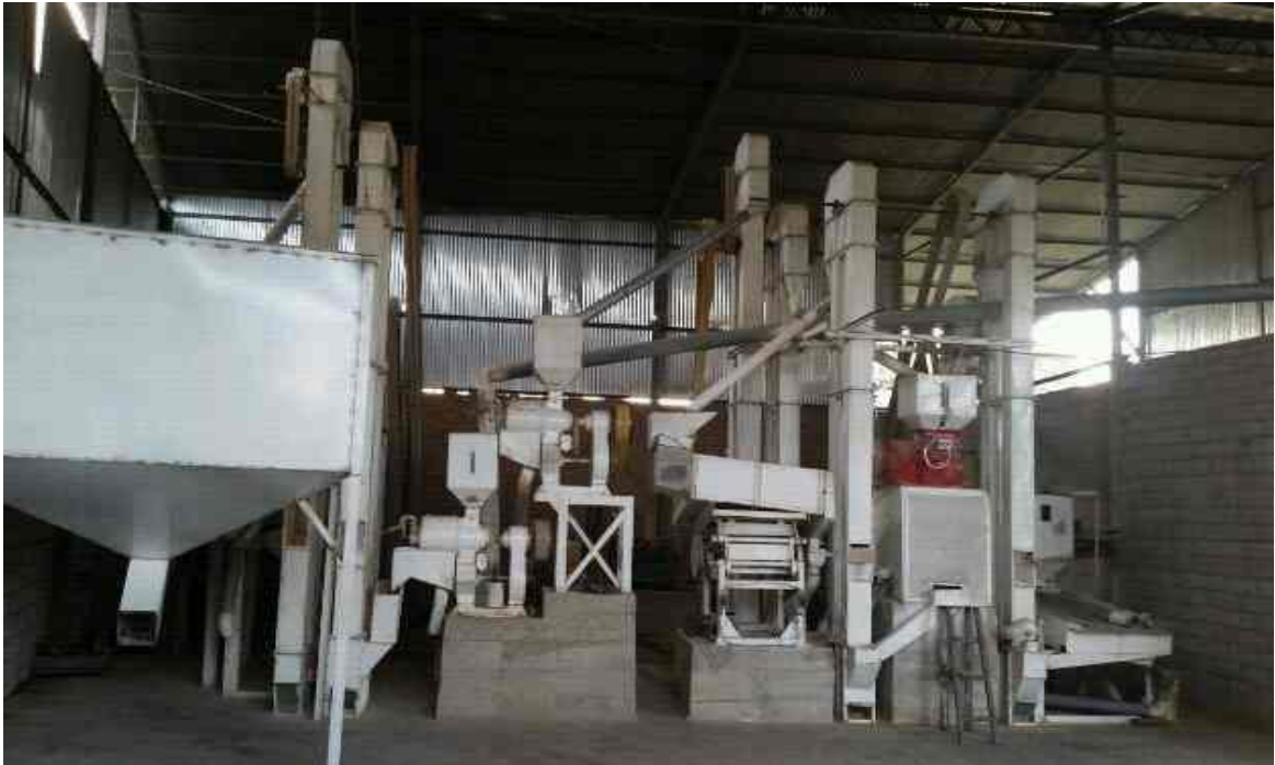
Equipos utilizados en pilado de arroz – Piladora Rey León S.A.C
