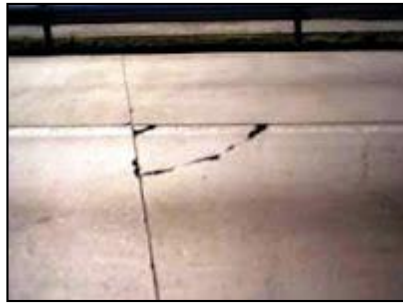
Grafico 14: Tipo de Grieta
