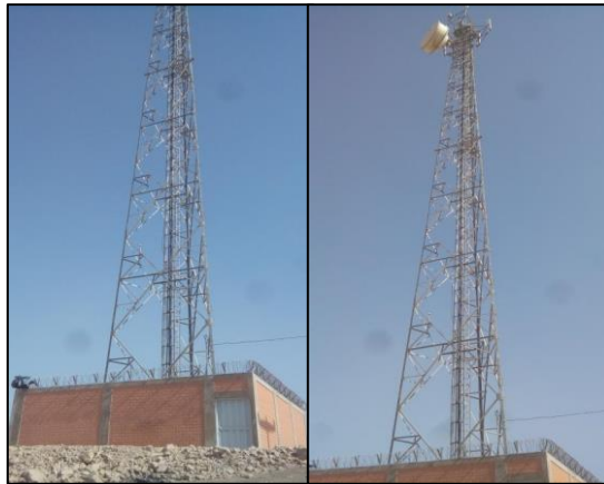
Figura N° 01: Vista Frontal de la BTS 3G- Empresa Claro – Locumba Fuente: Obtención
