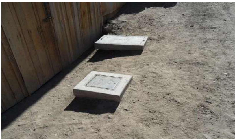
Figura 3.7: Servicios de agua potable
