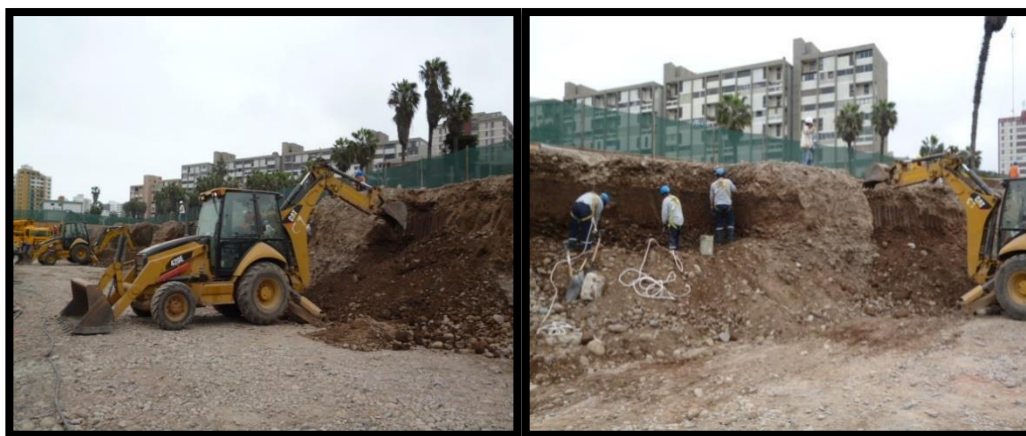
Fig. 2.1.2.3.3 A la izquierda, se observa una retro excavadora cortando las bermas donde se va a construir los muros. A la derecha, se observa obreros perfilando manualmente el talud.
