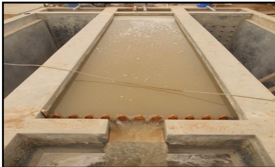
Fig. 16: Tanque del Sedimentador, primer efluente utilizado.
