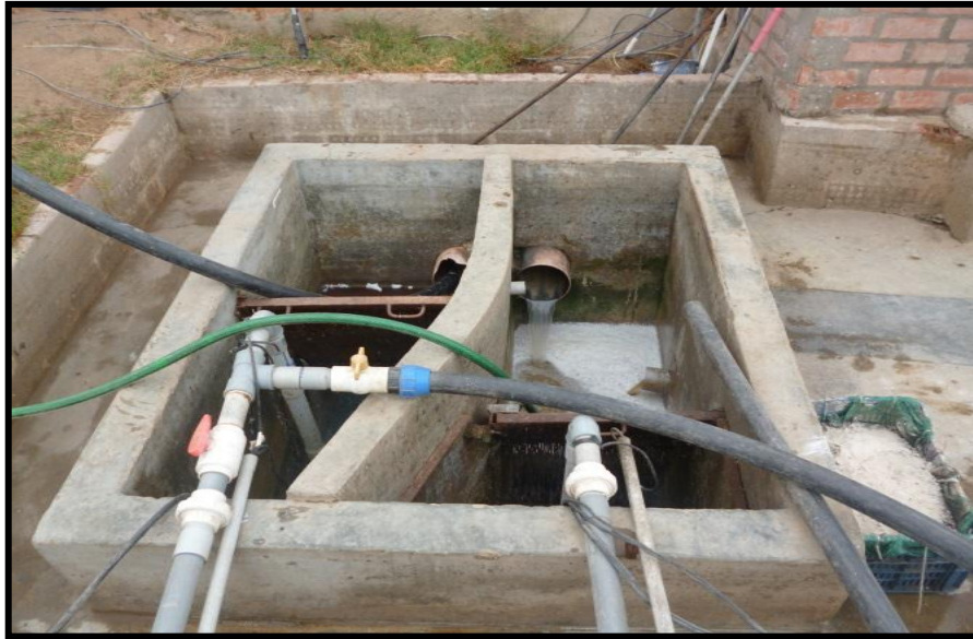
Fig. 17: Desemboque del efluente de procesos hidrobiológicos en la cámara de rejillas.
