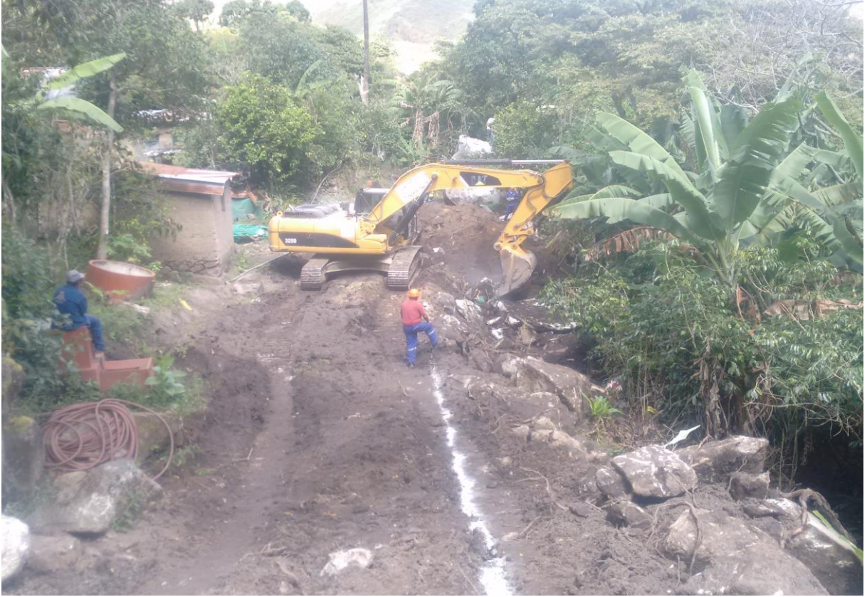
Fotografía 5: Trazo de carretera pasa por viviendas existentes, (Conflicto social).
