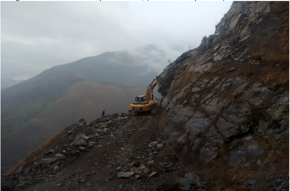
Fotografía 8: Cortes de talud pronunciado, (Maniobras especiales).
