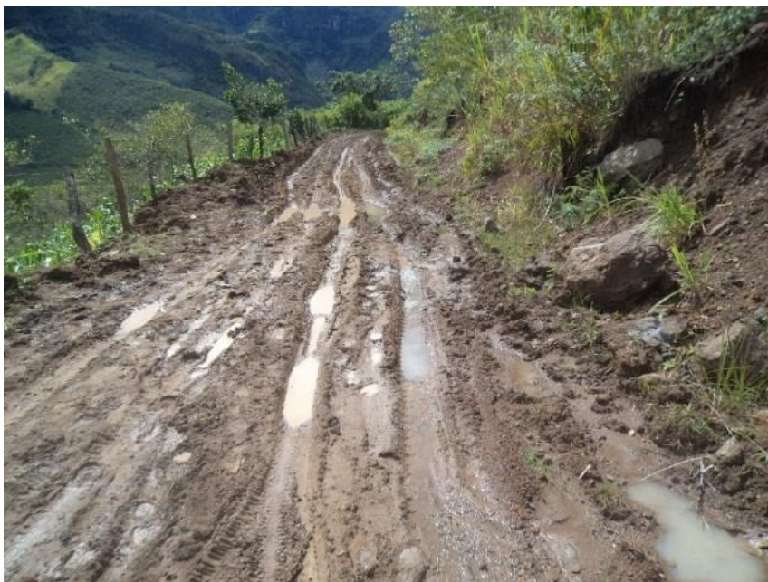
FOTO 2: SE APRECIA EL ESTADO DE LA VIA
