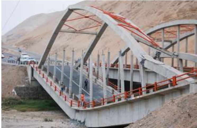
FOTO 01 Puente Topara-Jahuay-Chincha- Fallo , Colapso
