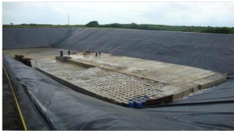
Figura 90 Celdas de seguridad Fuente: (Tecniamsa, 2010)
