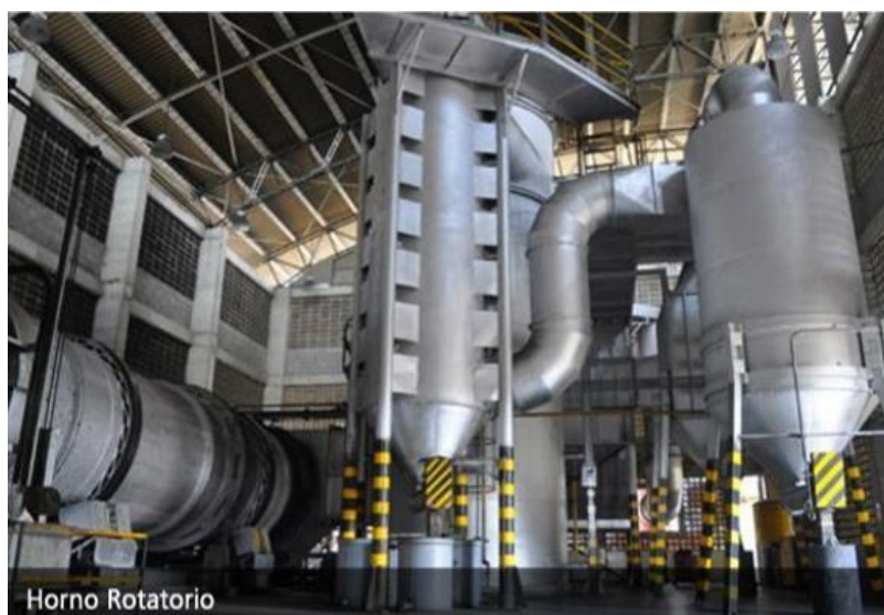
Figura 89 Hornos de incineración Fuente: (Tecniamsa, 2010)
