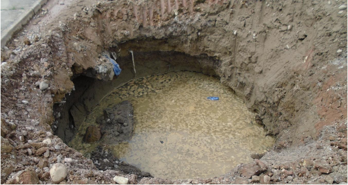
FOTO N° 5: ACUMULACIÓN DE AGUA PRODUCTO DE FILTRACIONES SUBTERRANEAS
