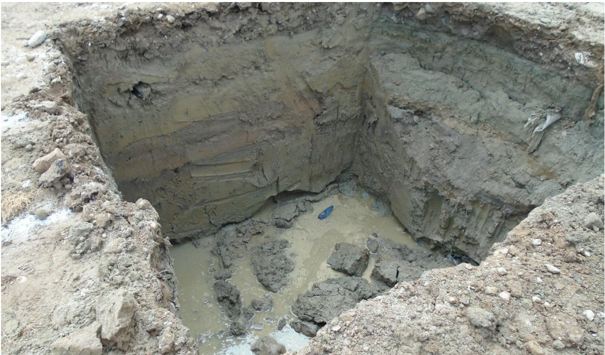
FOTO N° 4: FILTRACIONES DE AGUA EN LAS EXCAVACIONES DESTINADAS A LAS ZAPATAS
