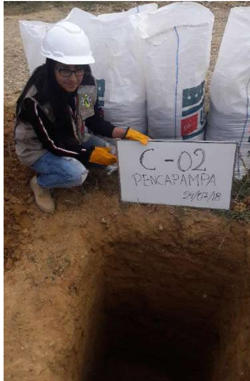
Figura N°6. Vista del perfil estratigráfico de la calicata 2, ubicada en el km 0+250 de la carretera Pencapampa
