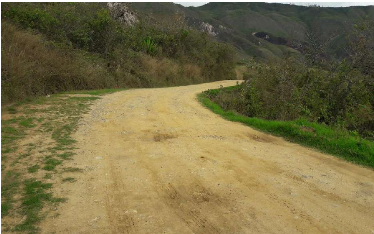
Figura N°4. Nótese la Presencia de baches en la carretera a Pencapampa.
