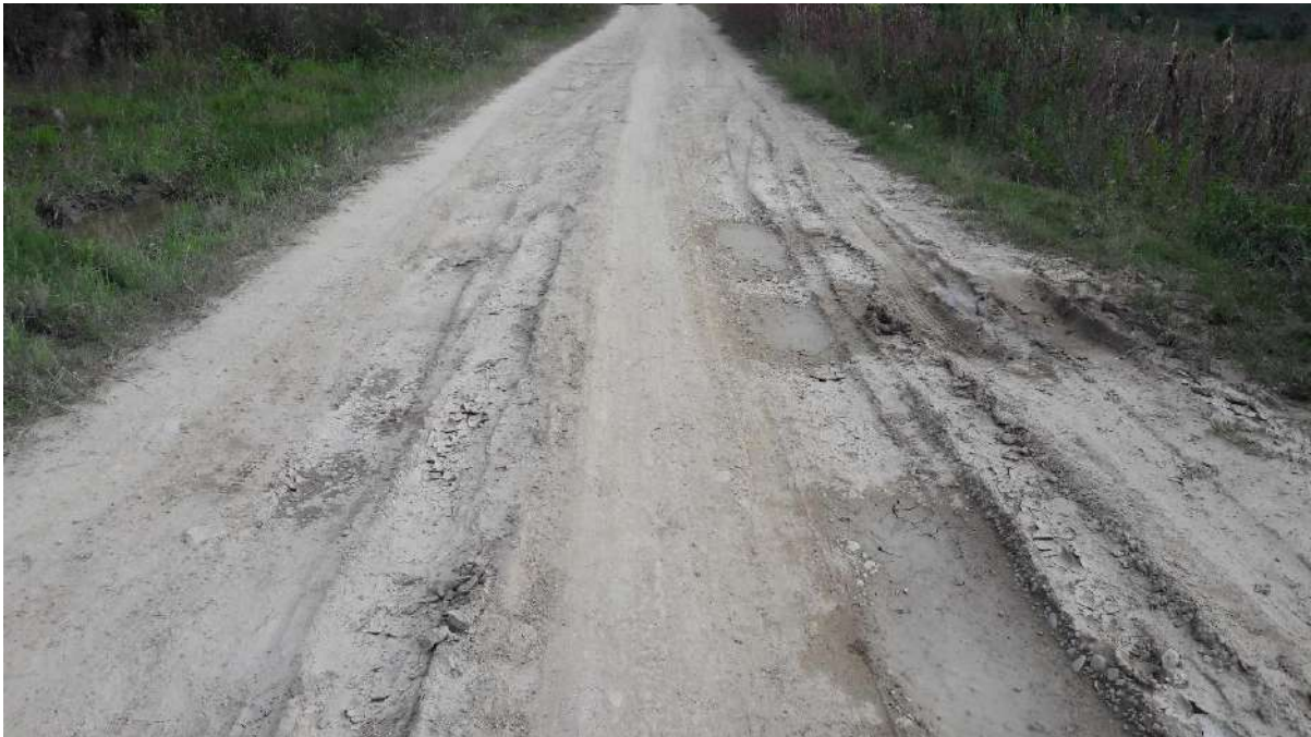
Figura N°5. Nótese la presencia de lodazales a lo largo de la vía
