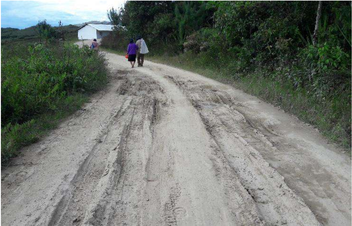
Figura N°3. Mal estado de la carretera a Pencapampa
