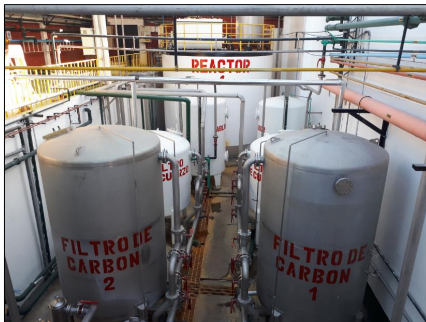
Figura 1. Planta de tratamiento de agua 1
