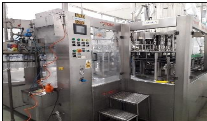
Figura 11. Máquina llenadora (parte externa)
