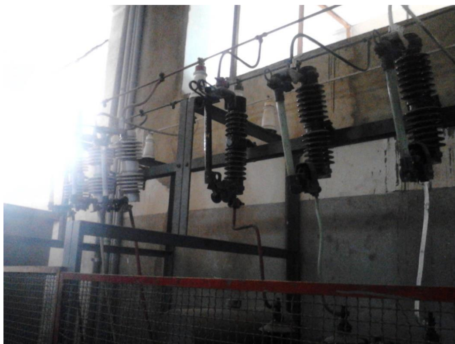
Imagen 4: Acometida interna del sistema eléctrico del Hospital III
