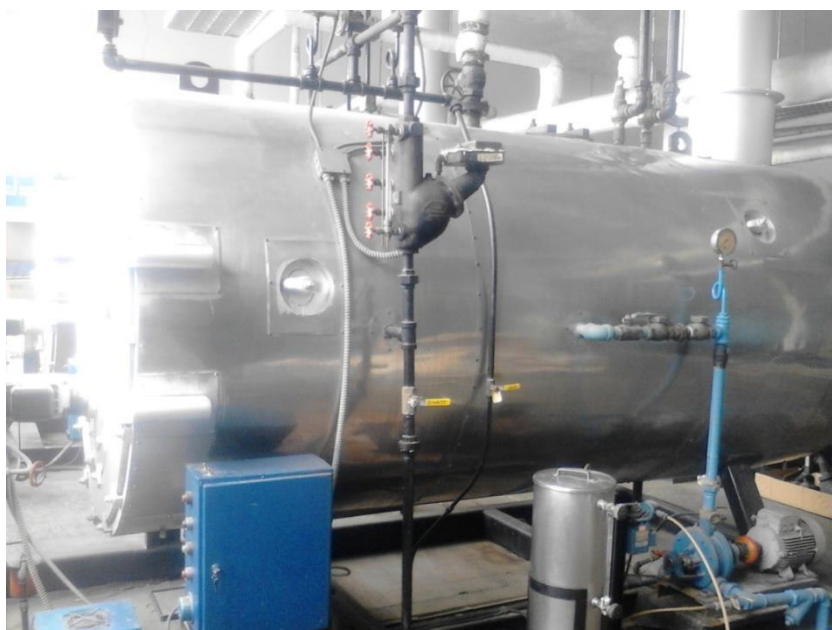
Imagen 2: Caldero Piro-tubular N°02, marca INTESA, 100BHP
