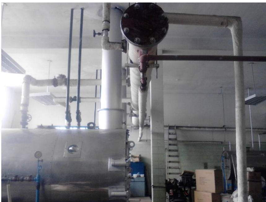
Imagen 1: Sala de Calderos del Hospital III
