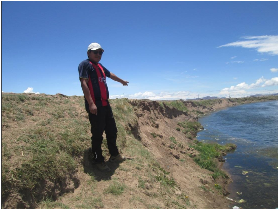
Fotografía 1. Se aprecia la erosión del talud por efecto de la socavación.
