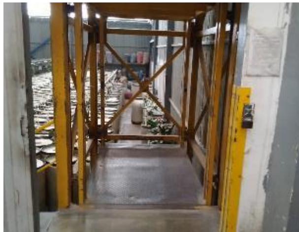
Observación N°10: Montacargas
