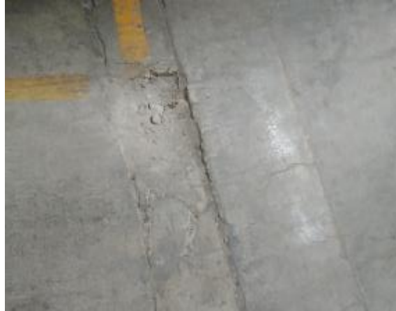
Observación N°13: Pisos Deteriorados
