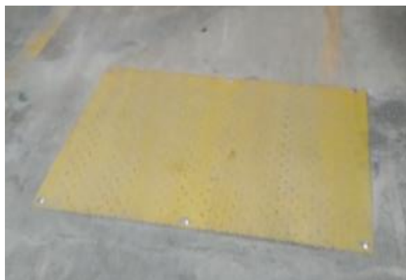
Mejora N°13: Plancha de Metal en Rampa
